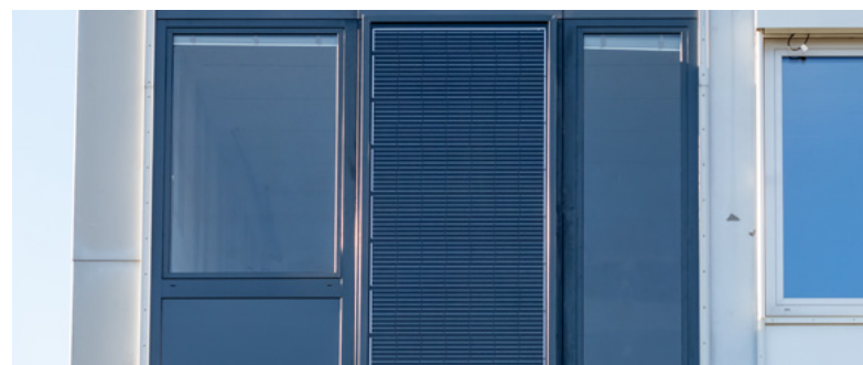
EE-Modul-Fassade mit Photovoltaikfläche im mittleren Segment an der Versuchseinrichtung für energetische und raumklimatische Untersuchungen (VERU).
