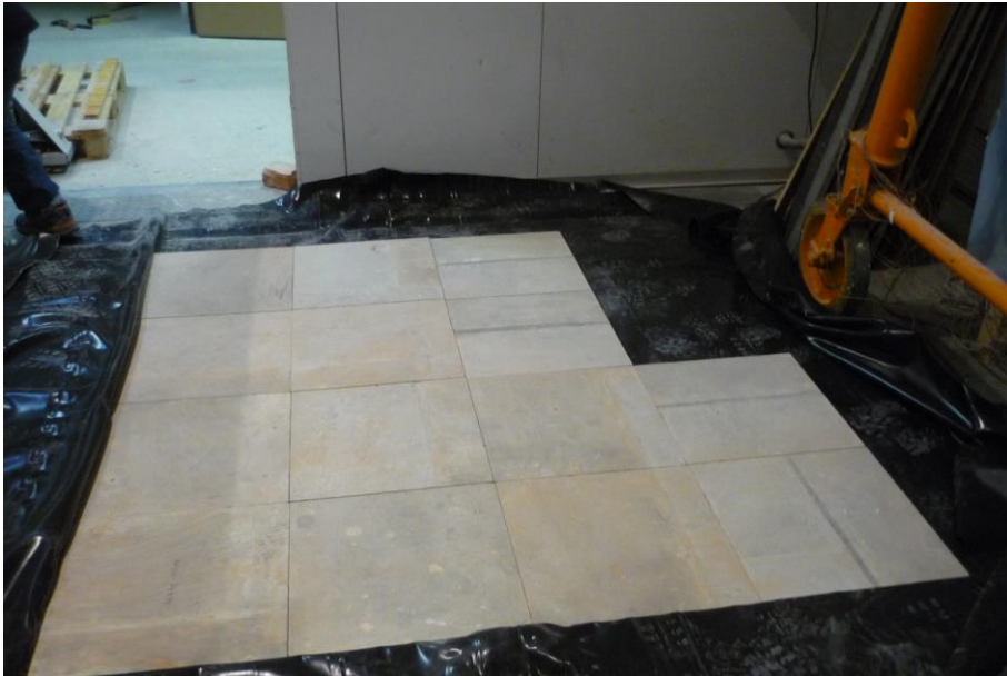
Bild 7: Fußbodenaufbau – Beton mit darunterliegender Folie (Räum A, B, E, F, G und H).
