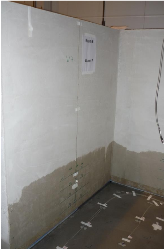
Bild 43: Durchfeuchtung der Wand 7 in Raum E (Innenansicht) nach drei Tagen Bewässerung.
