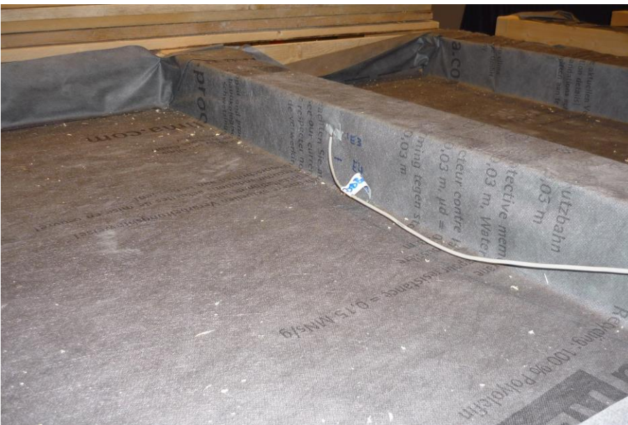
Bild 18: Schutzbahn unter der jeweiligen Schüttung (Raum C und D) und Widerstandssensor im mittleren Balken.
