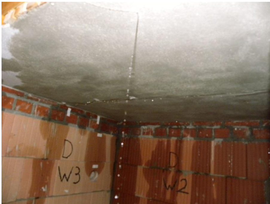
Bild 42: Durchfeuchtung der Deckenunterseite nach ca. 5 Stunden Bewässerung (Raum D, Lehmpelletfüllung).
