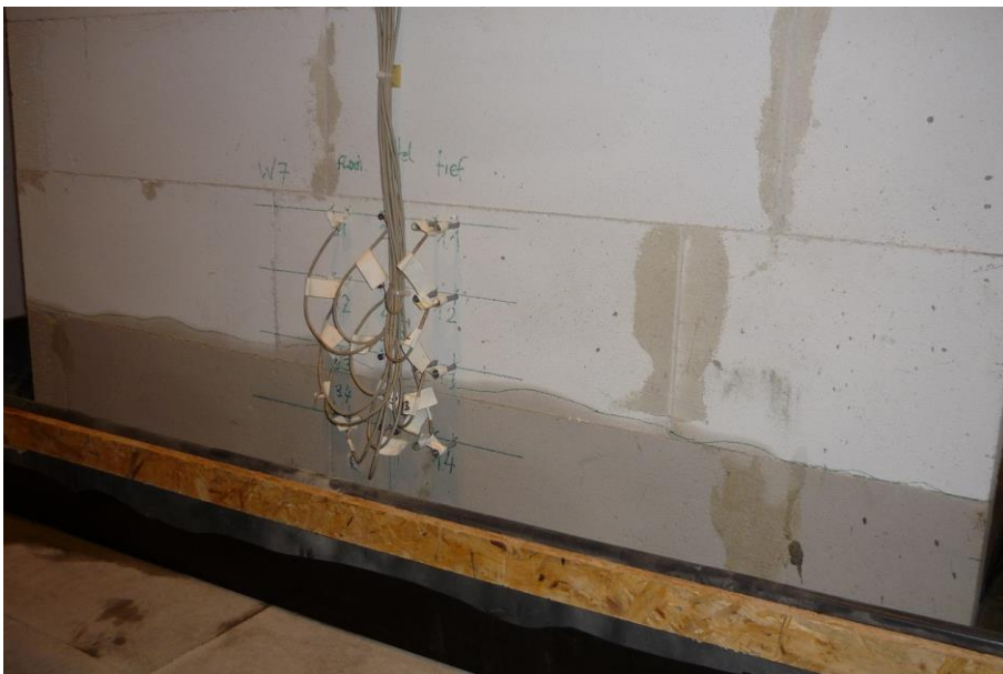
Bild 44: Durchfeuchtung der Wand 7 in Raum E (Außenansicht) nach drei Tagen Bewässerung.
