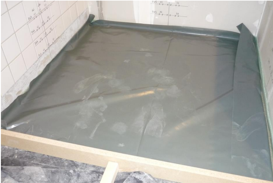
Bild 13: Fußbodenaufbau – Folie zwischen Dämmung und Estrich (Raum B).
