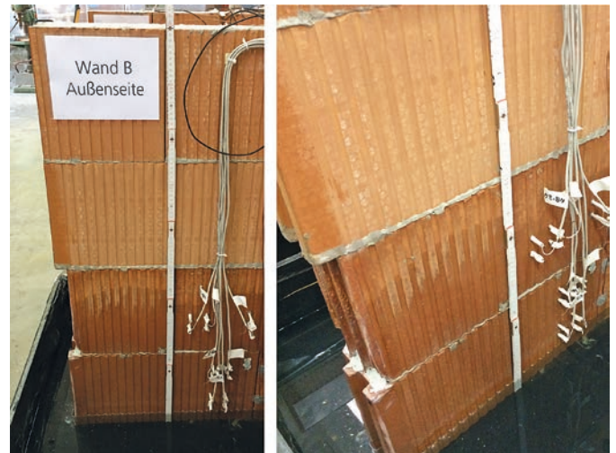
Bild 6. Sichtbarer Feuchteanstieg an der Außenseite von Wand B am Ende der Bewässerung Fig. 6. Visible increase of moisture at the outside of wall B at the end of the wall irrigation
