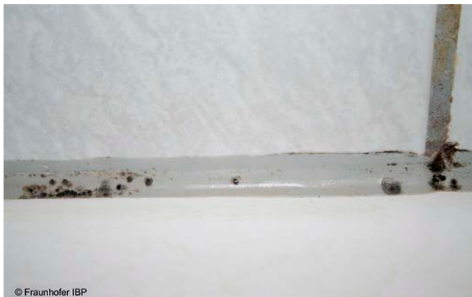
Bild 1. Typische schwarze Verfärbung an einer Silikonfuge in einem Badezimmer (Quelle Fraunhofer IBP)
